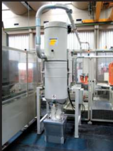
Bei maximalem Füllstand im Sammelbehälter des TowerVacs wird das Sauggut automatisch in die Unterflur-Förderrinne entleert.
